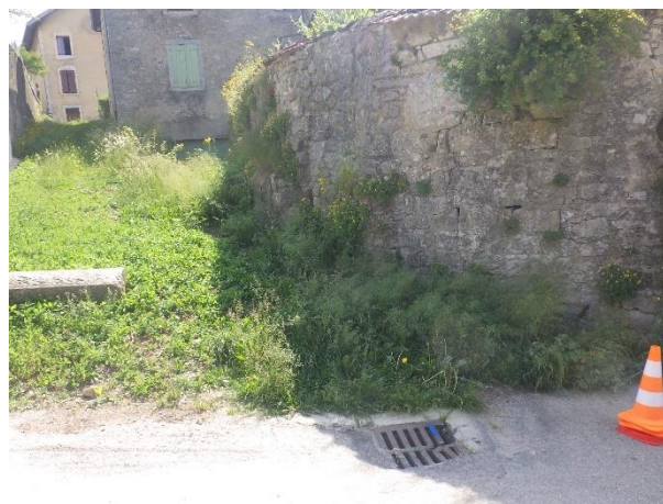
Rue des sœurs – grille cassée
