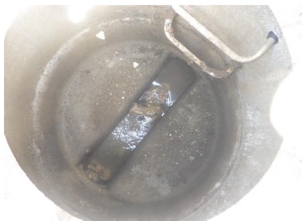
Le moulin - Présence de dépôts
