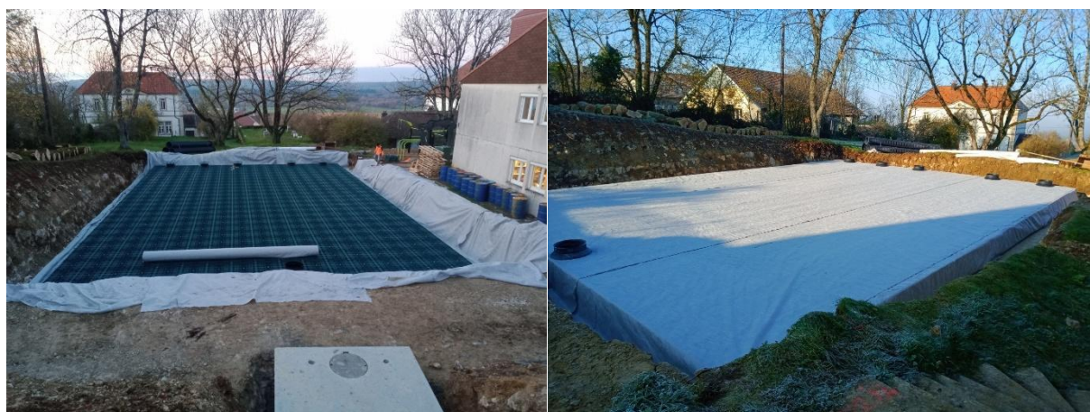
Exemple de bassin stockage-infiltration (BSI)
