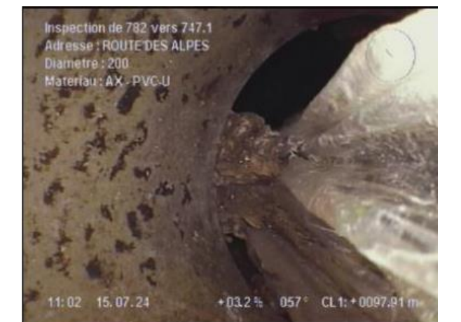
Bêche bloquant l'écoulement provenant d'un joint
