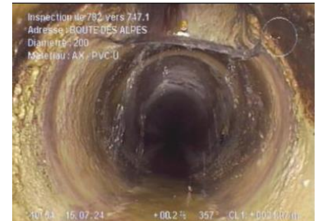
Écoulement d'ECPP dans branchement
