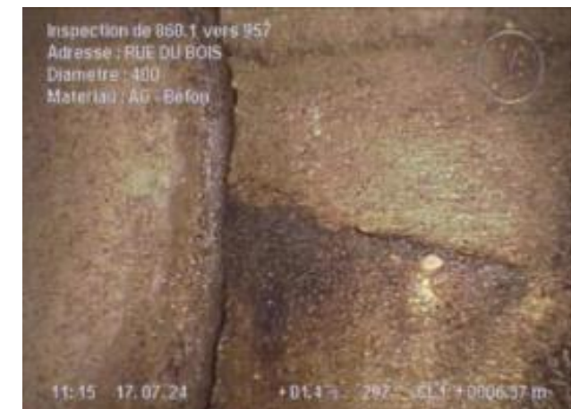
Fissures complexes Rue du Bois
