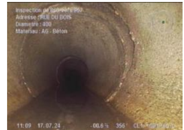
Trou dans revêtement Rue du Bois
