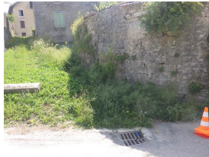
Rue des Sœurs – Grille cassée
