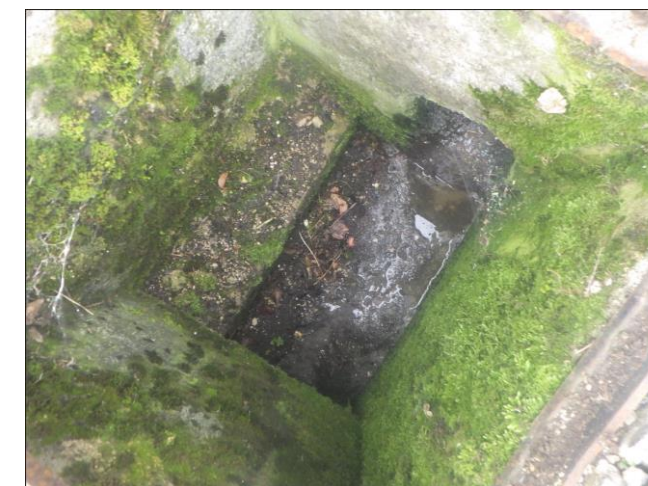
Grille unitaire – Rue des Essarts
