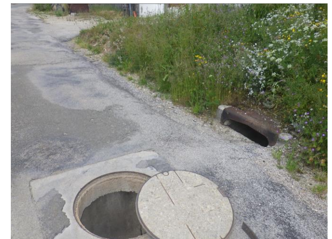
Regard pluvial – Rue du château
