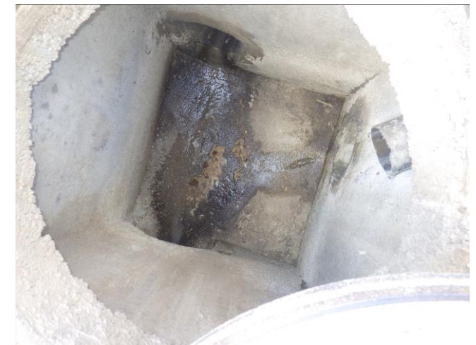
Regard pluvial – Rue du château
