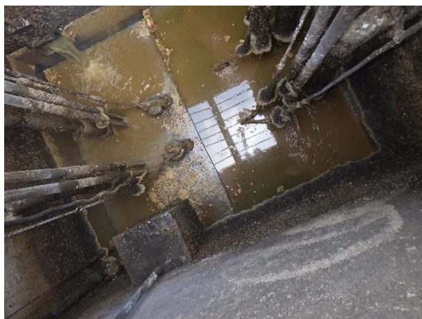
PR Entrée STEU
