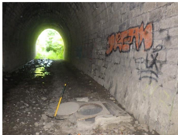
Tunnel - Cadre non scellé
