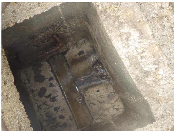
Rue des Ravières – Stagnation d'effluents
