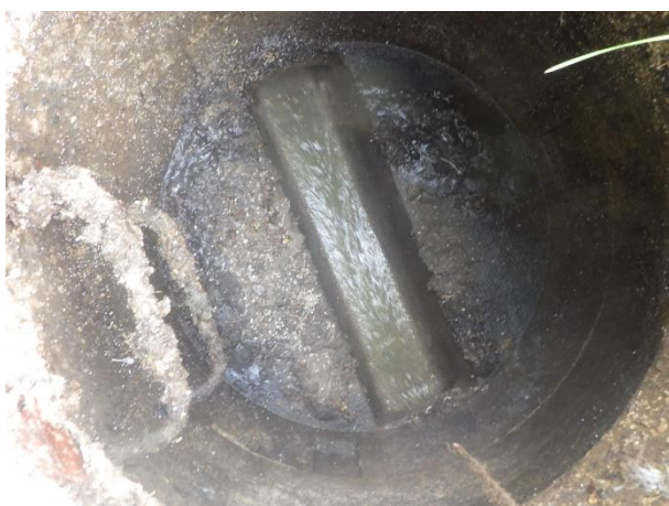
Regard amont PR STEU – Traces de mises en charge
