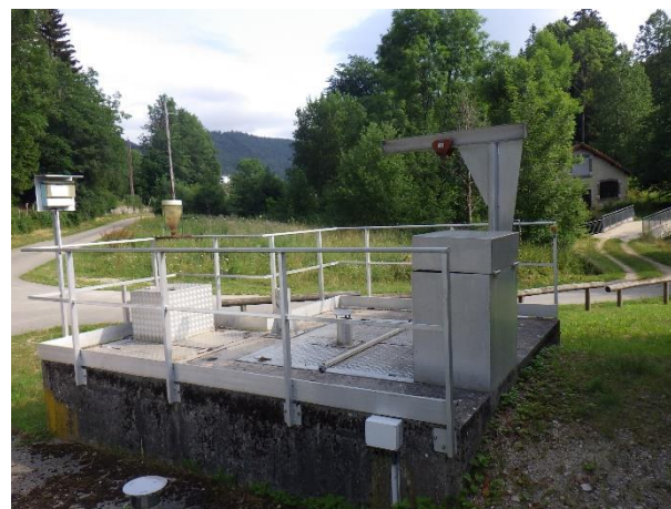
PR Entrée STEU
