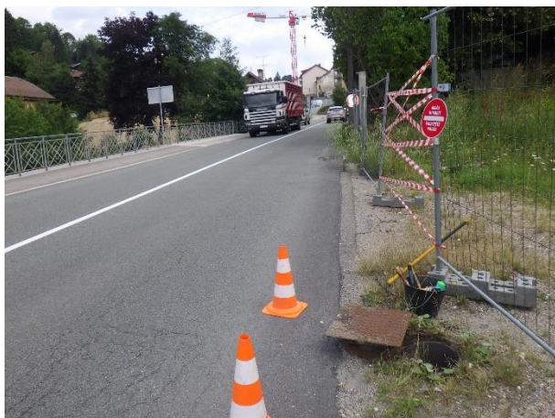
Rue des sœurs – boîte de branchement non scellé
