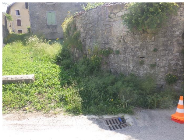
Rue des sœurs – grille cassée
