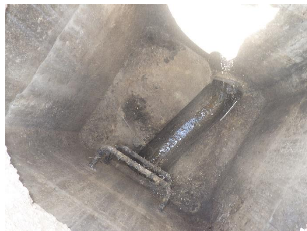
Rue du Balland – Trace de mise en charge
