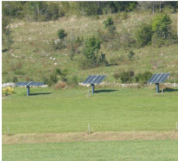
Trackers solaires installés au hameau de Vuillet
